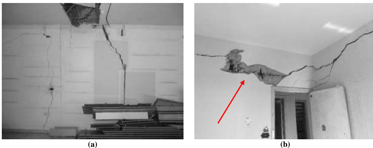
Figura 5 – (a) Aspecto de fissuras vertical em alvenaria da parte interna do imóvel e (b) Descolamento do revestimento da alvenaria em um cômodo do imóvel vistoriado
