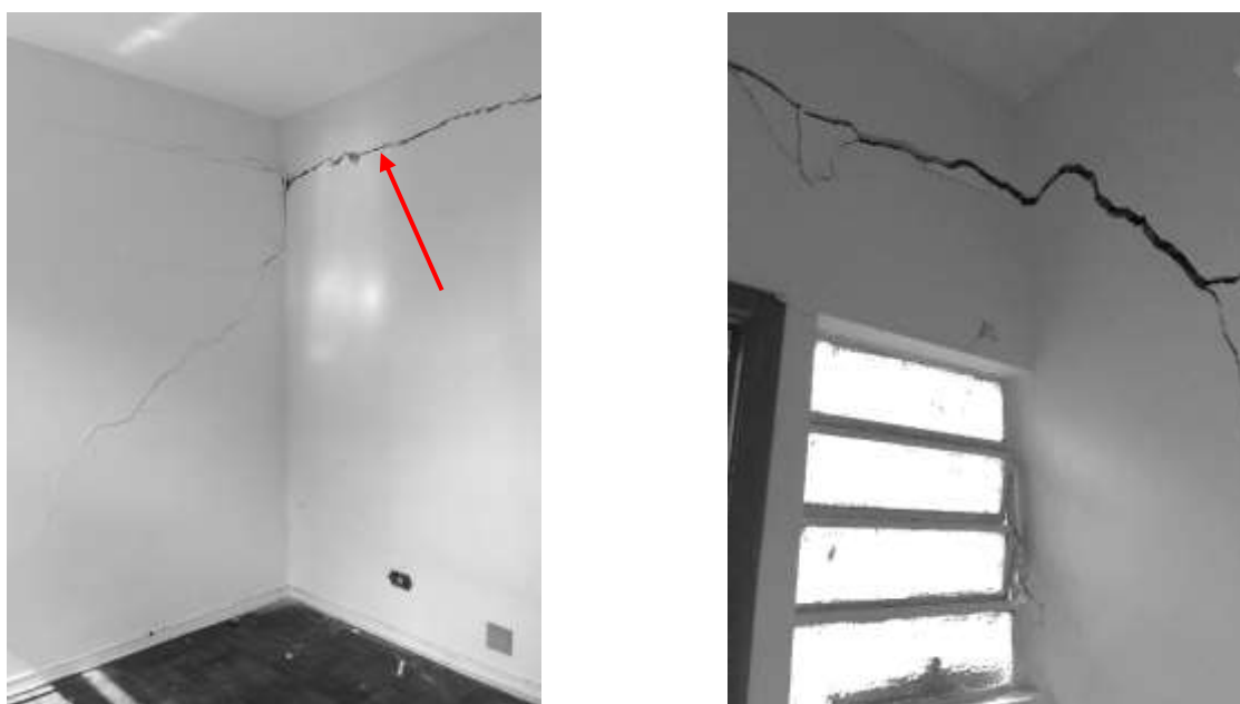
Figura 8 – Configuração de fissura entre alvenaria e viga após o recalque diferencial de fundação
