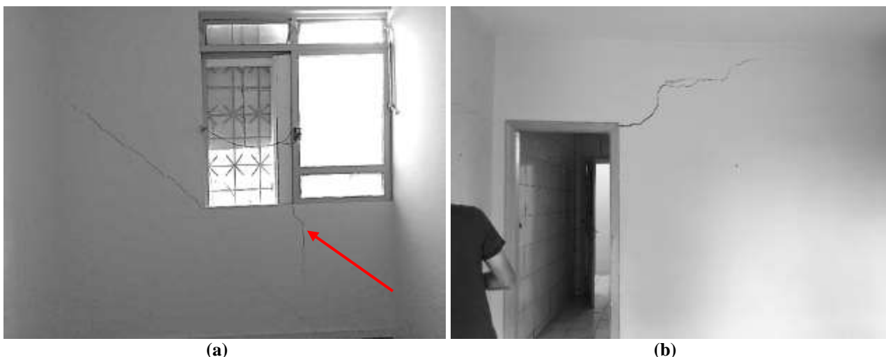
Figura 7 – (a) Fissura vertical no peitoril da janela e (b) fissuração típica nos cantos da abertura de porta, sob atuação de sobrecarga
