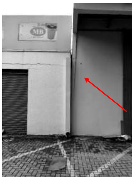
Figura 3 – Aspecto da repercussão dos efeitos da movimentação estrutural.
