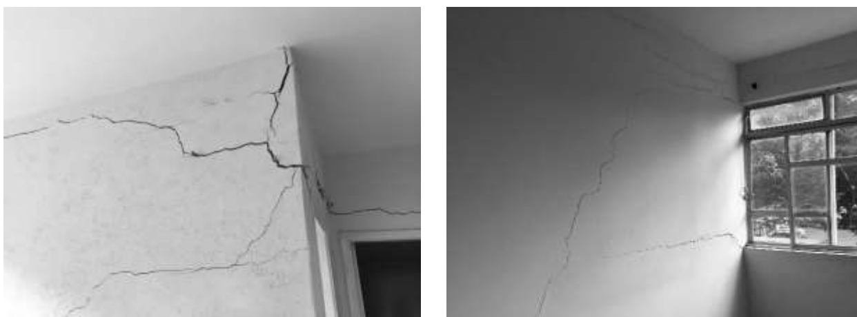
Figura 6 – Fissuras resultantes do recalque diferencial de fundação
