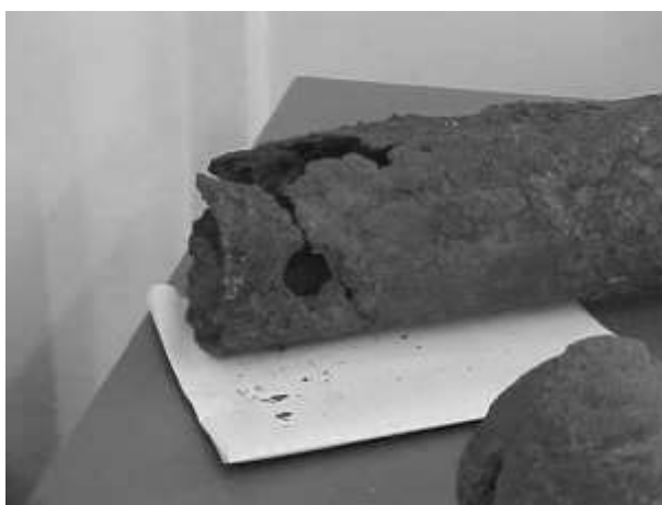
Figura 2 – Oxidação de trecho de ferro fundido da rede de distribuição de água
