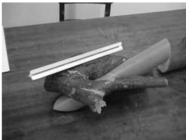
Figura 3 – Quebra de trecho da rede de distribuição de água em PVC por raiz de árvore
