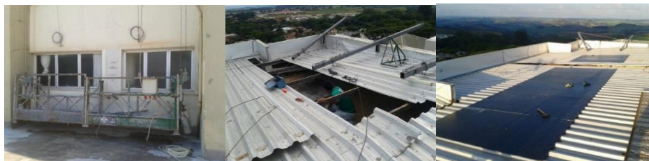
Figura 5 – Balancim elétrico instalado em uma das fachadas do edifício
